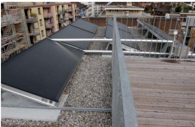
Sonnenkollektoren auf dem Dach der Wogeno, Zürich
